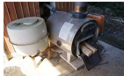
木材により風呂をわかす薪ボイラー
